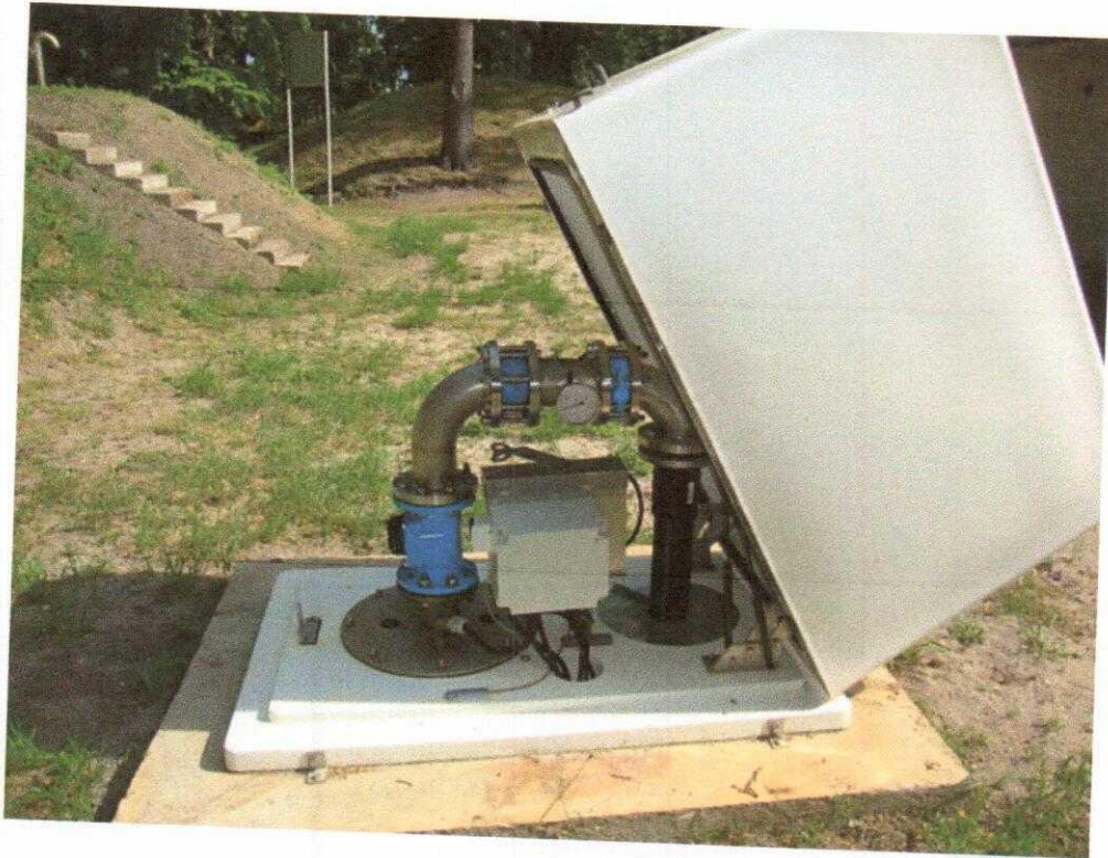
Studnia głębinowa stacja Uzdatnia Wody Borowe
