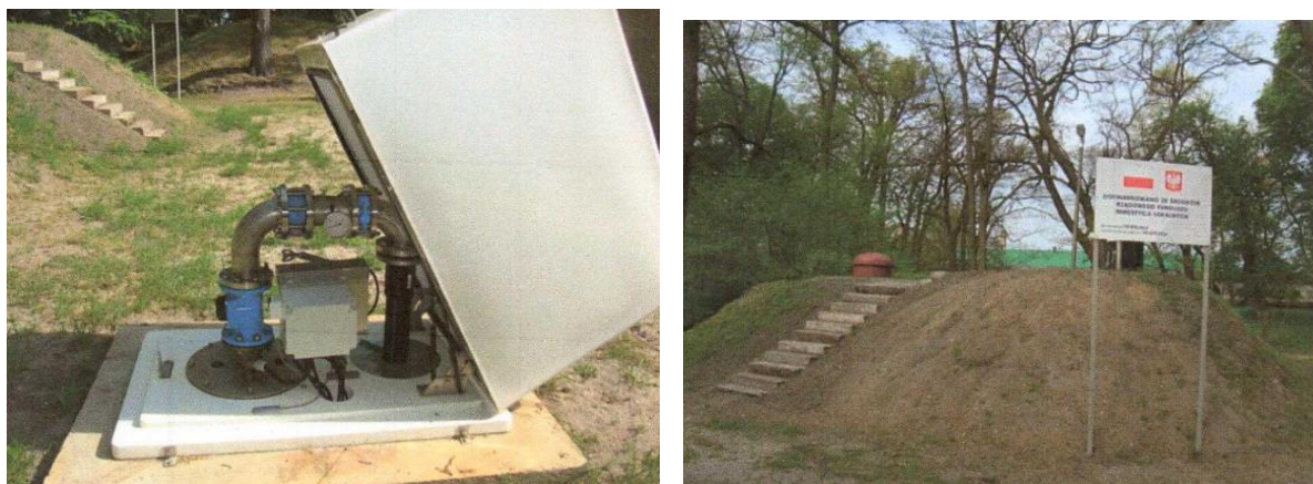
Zdjęcie 4. Studnia głębinowa – stacja Uzdatniania Wody Borowe
