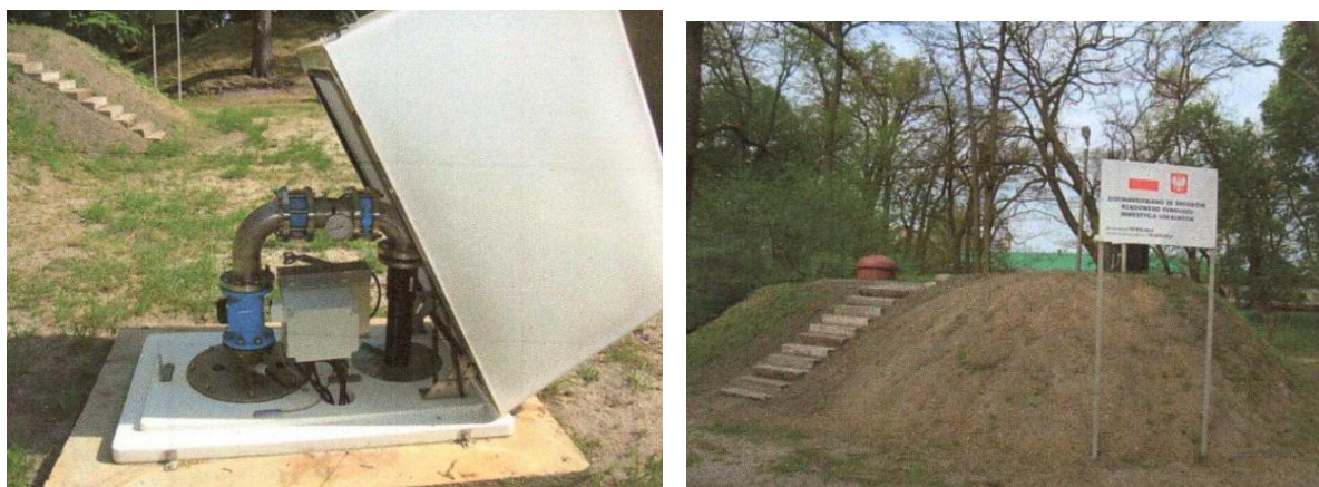
Zdjęcie 4. Studnia głębinowa – stacja Uzdatniania Wody Borowe
