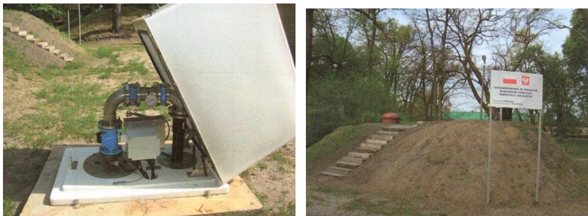
Zdjęcie 4. Studnia głębinowa – stacja Uzdatniania Wody Borowe
